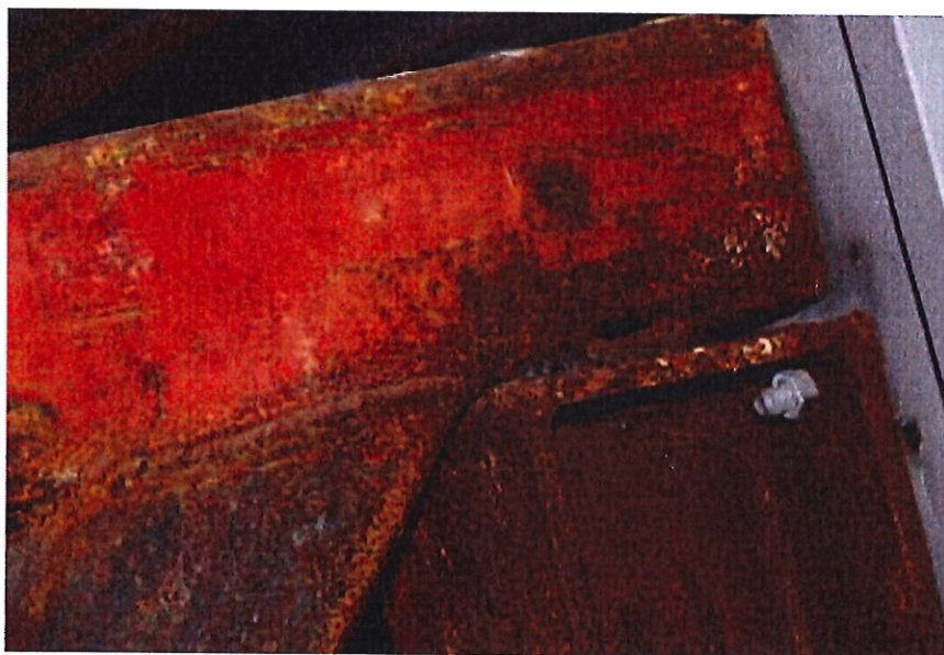
Akse 2/A: Dårlig sveis over søyle og hull i røret og antydning til sprekk i godset.
