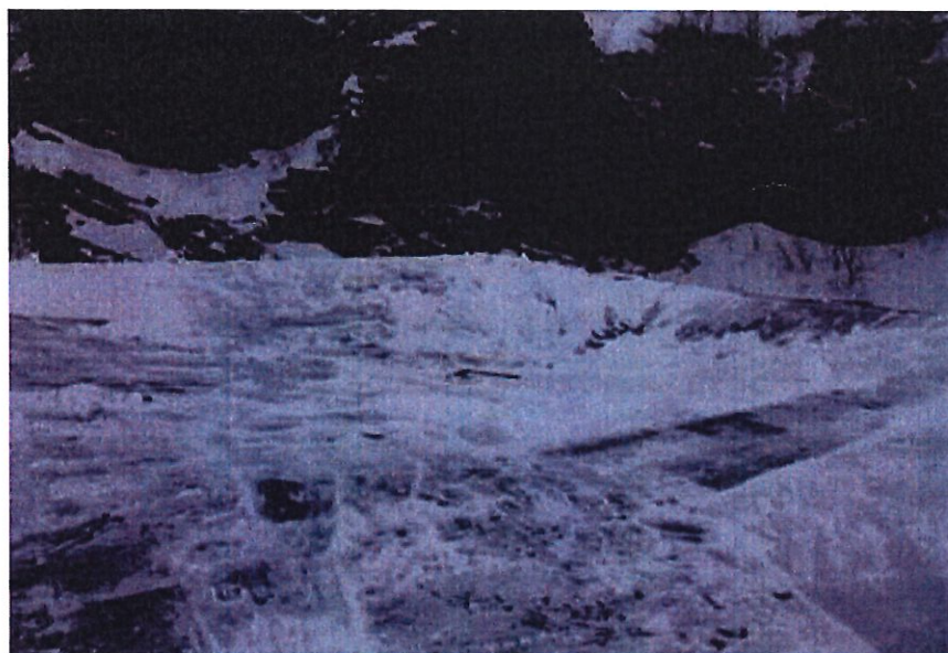
Yttertaket med dump i taket som er brutt sammen
