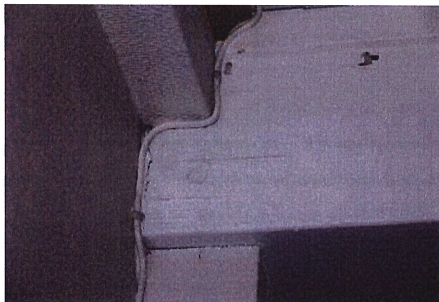
Vertikal sprekk og synlige horisontale lameller over opplegg for limtre drager mot akse 3, rotasjon over opplegg.
