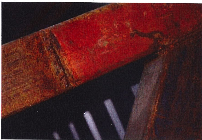
Akse 2/A: Overgurt skjøtet før diagonal til undergurt, manglende overflatebehandling.
