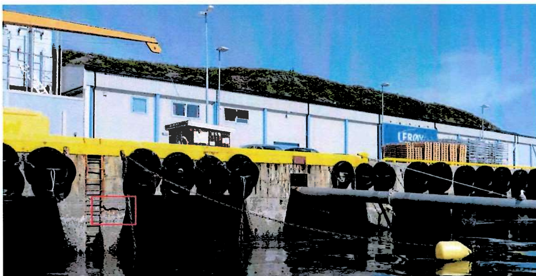
Bilde 2. Sprekk i betongen
