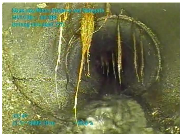
Figur 4: Fellesledning Klaus Dreyers vei, røtter trenger inn ved skjøtene samt sprekkdannelser i rørveggen
