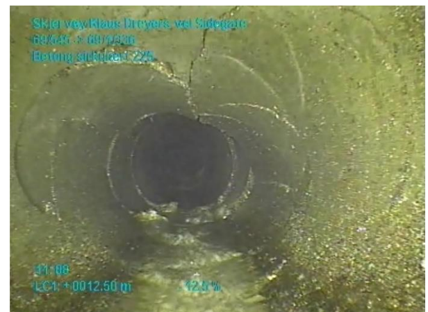
Figur 5: Fellesledning Klaus Dreyers vei, rørveggen har kollapset
