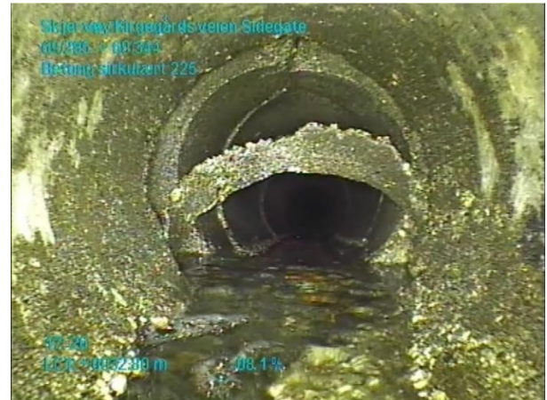
Figur 3: Fellesledning Kirkegårdsveien, delvis ledningskollaps
