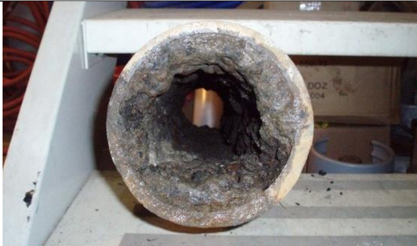
Figur 1: Eksempel på gammel vannledning av grått støpejern. (Kilde: Teknisk Ukeblad)
