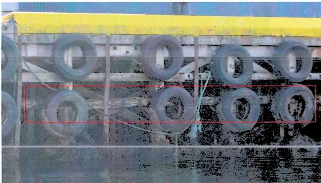
Bilde 13. Råteskader i det horisontale treverket i fronten av kaien
